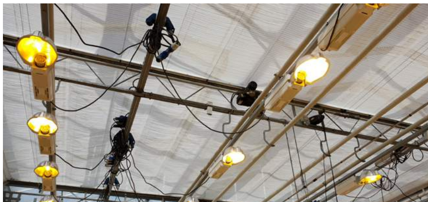
Foto 7 Lampada HPS (High Pressure Sodium)
